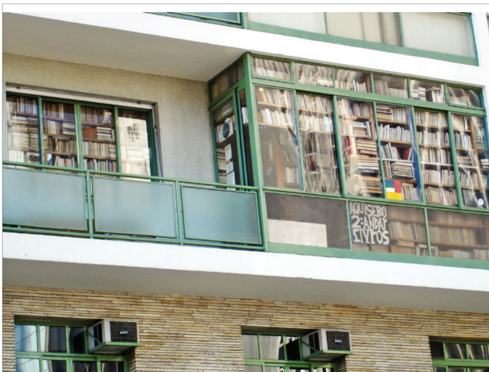
Foto 5 - Uso inadequado provocando sobrecarga não prevista - Fase U do PPEU
