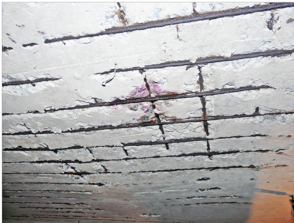
Foto 2 – Deficiência de cobertura em laje de concreto – Fase E do PPEEU
