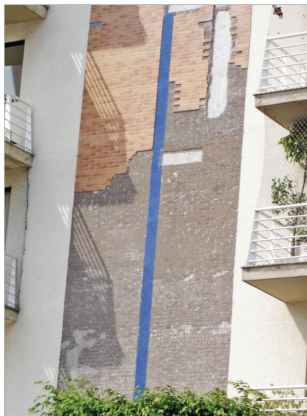
Foto 6 - Deficiência de projeto de mão de obra na execução - Fases P e U do PPEU
