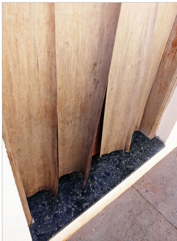
Foto 4 – Deficiência de especificação de porta não indicada para ambiente externo sujeito às intempéries: Deveria ser em madeira maciça e não folheada – Fase P do PPEEU
