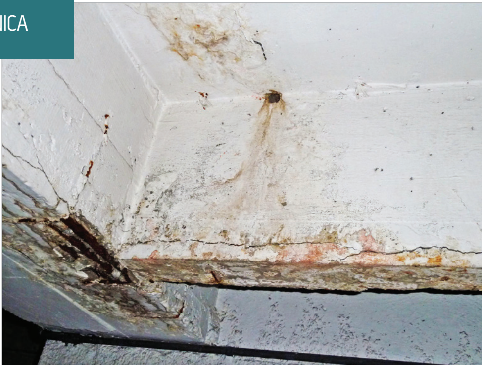
Foto 3 – Deficiência de manutenção em laje de concreto, agravada devido infiltração – Fase U do PPEEU
