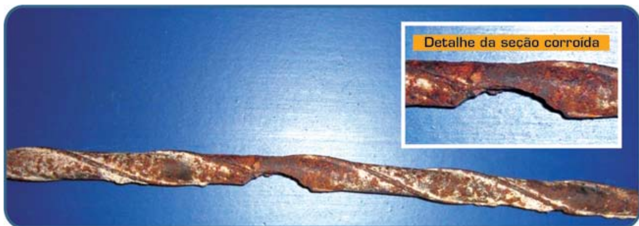
Figura 6 – Barra com corrosão localizada. No local da corrosão a estrutura apresentava uma fissura
