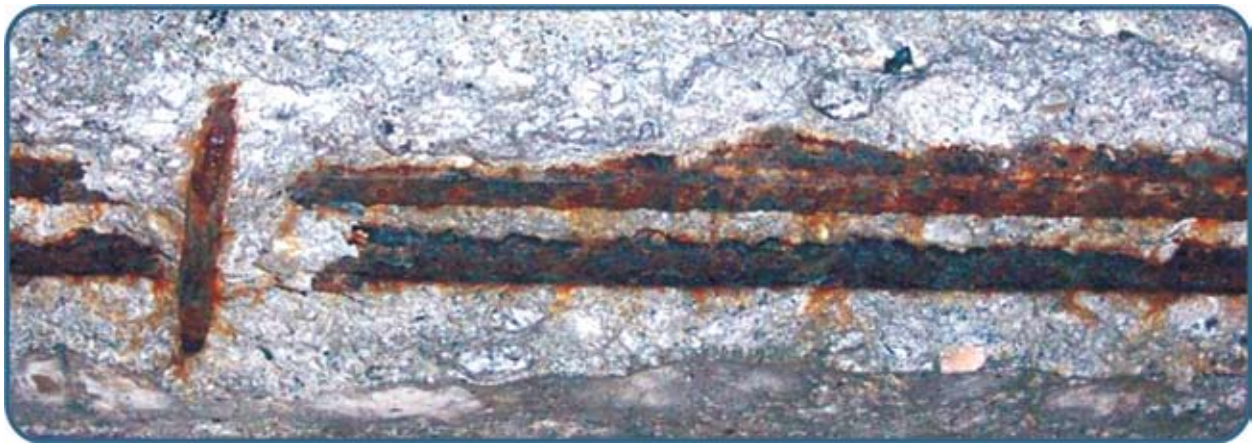
Figura 7 – Armadura com corrosão generalizada
