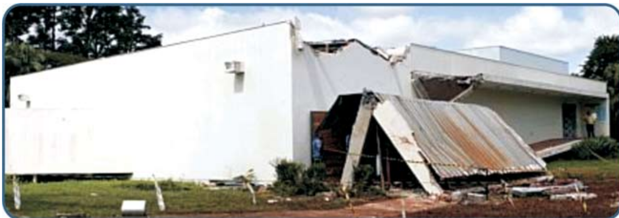
Figura 2 – Desabamento de marquise do Anfiteatro da Universidade Estadual de Londrina
