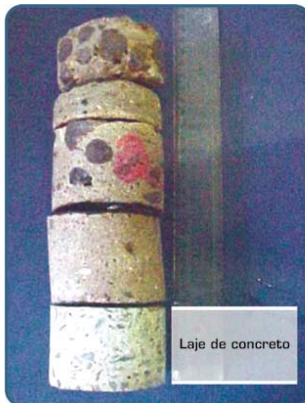
Figura 8 – Exemplo de camadas de sistemas de impermeabilização sobrepostas sobre laje de marquise
